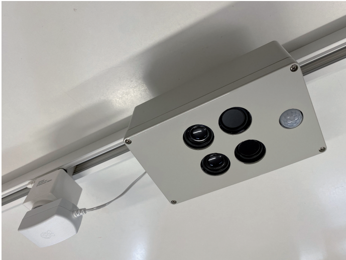
Hörstation an der Stromschiene mit IR Bewegungssensor
