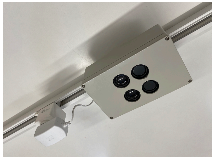
Hörstation an der Stromschiene, Deckenmontage
