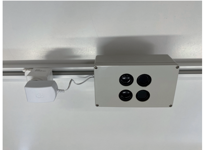
Hörstation an der Stromschiene ohne Bewegungssensor
